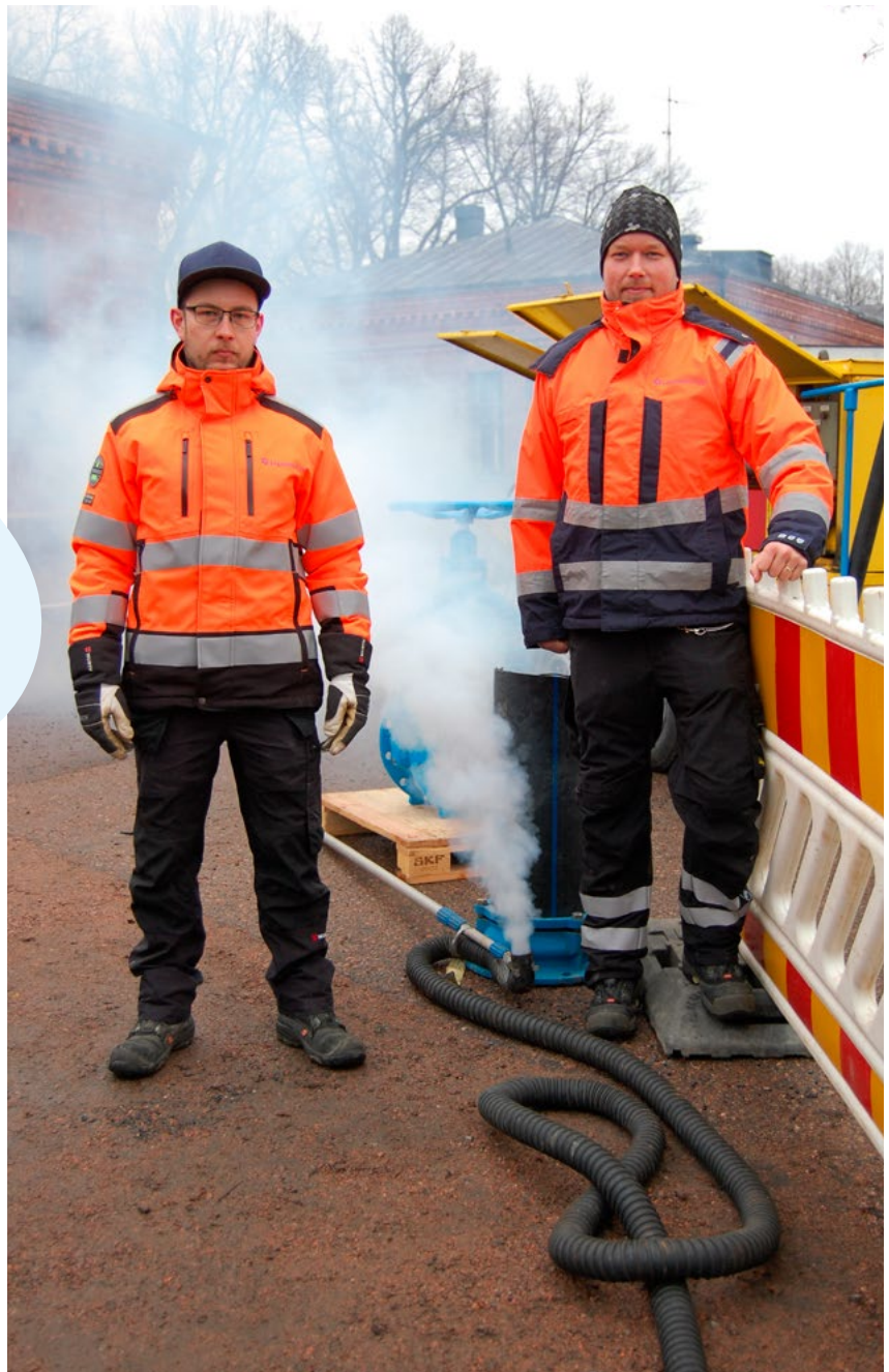
Joni Seppälän (vas.) ja Sami Mustosen jalkojen juuresta tuli savua ilman tulta. Savua käytetään selvittämään putkireittien kulkemista. Näin keväällä sade- ja sulamisvesiä kertyy runsaasti ja niiden on syytä kulkeutua hulevesiverkostoon.
